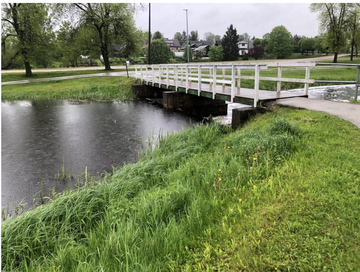
Foto 2. Vaade Pedeli III paisuregulaatorile Pedeli esimese paisjärve poolt (Kobras AS, 2021).
