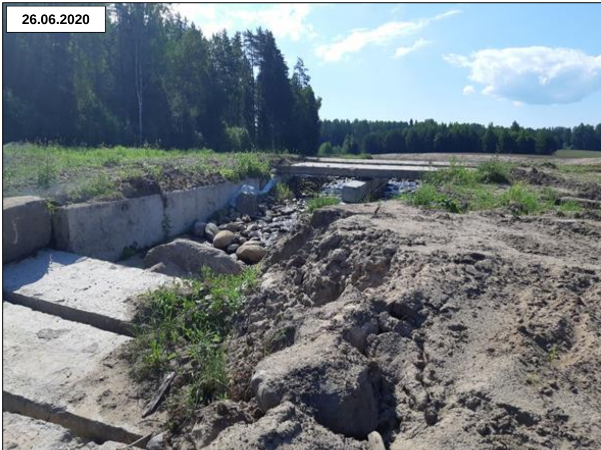
Foto 2. Paisutusrajatis Männiksoo_1 (PAIS27130) 2020. aastal toimunud Männiksoo (PAIS020050) objekti kontrollimisel (KeA, 2020)
